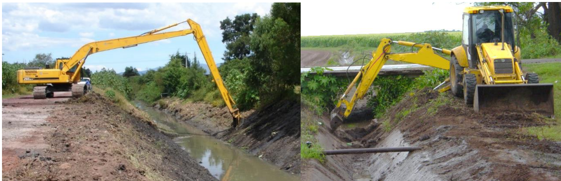
Figura 9. Extracción de azolve con excavadora hidráulica de largo alcance y retroexcavadora cargadora en el Distrito de Riego 010, Culiacán Humaya, Sinaloa.
